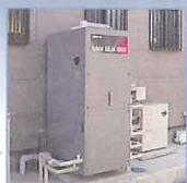
ポンプユニット
