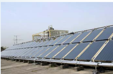
公団住宅・給湯
