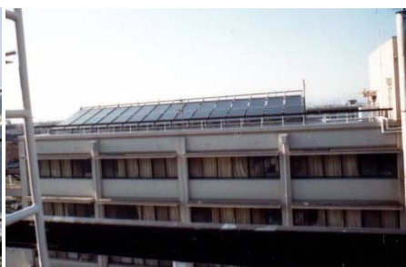
工場寮・給湯
